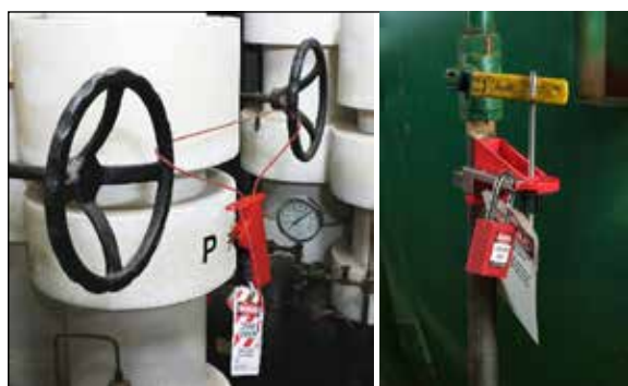
Figura 9. Bloqueo de válvulas (Brady) con LOTO.
